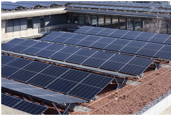
Dachlandschaft mit PV-Anlage
