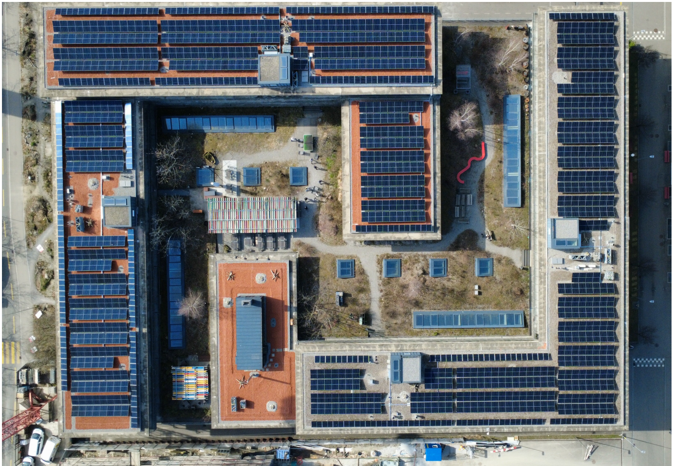
Vogelperspektive der PV Anlage
