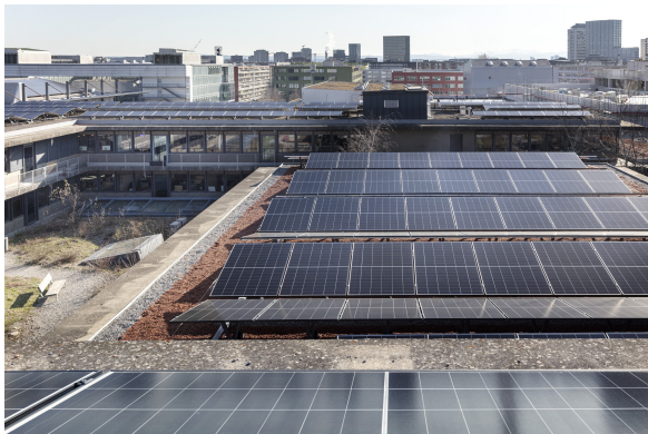
Dachlandschaft mit PV-Anlage
