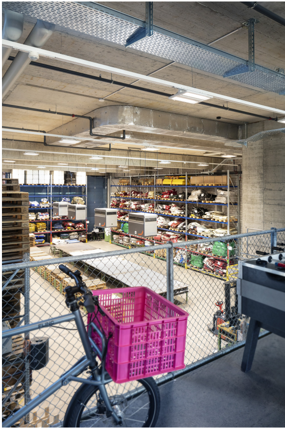
Neue Beleuchtung Halle
